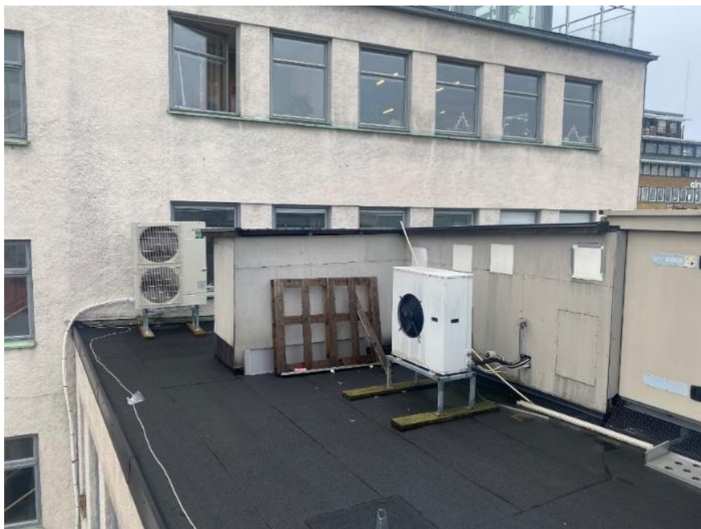
Figur 4.6 Källa nr. 6 (t.v.) och källa nr. 7 (t.h.) placerad på tak inom fastigheten Inom Vallgraven 56:1
